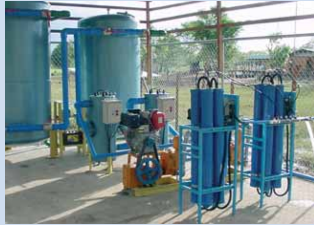
Planta desalinizadora construida en Tumaco en el 2003, que aporta agua saneada a las comunidades de trabajo. Global Humanitaria [Foto]
